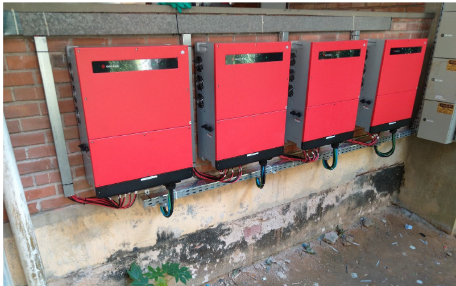
Foto 2: Inversores instalados no CEGOE - 4x 50kWp
