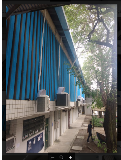
Foto 5: Instalação dos defletores das condensadoras dos ar-condicionados tipo Split do Salão Nobre
