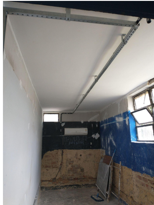
Foto 2: Sala onde o reboco precisou ser descascado para recomposição, perfilado e parte dos eletrodutos já instalado.
