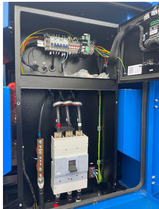
Foto 4: Quadro de comando do gerador de Pesca.
