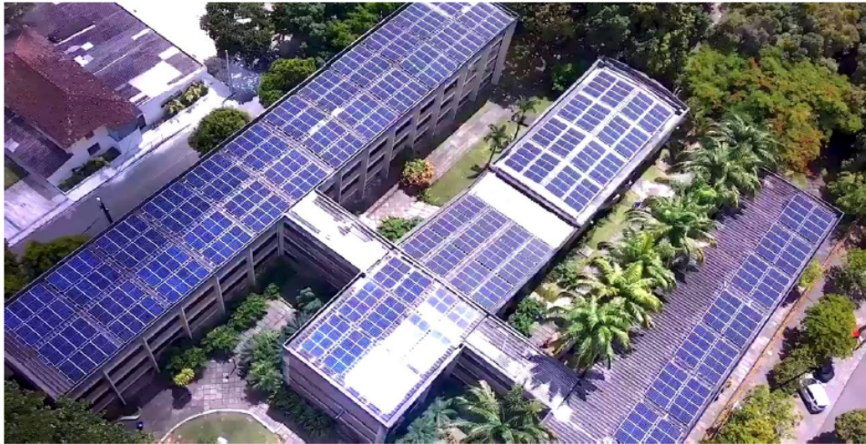
Foto1: Placas fotovoltaicas instaladas no CEGOE
