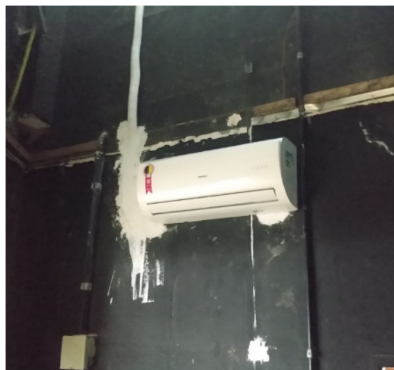
Foto 4: Instalação das evaporadoras dos ar-condicionados tipo Split das salas técnicas de áudio do Salão Nobre
