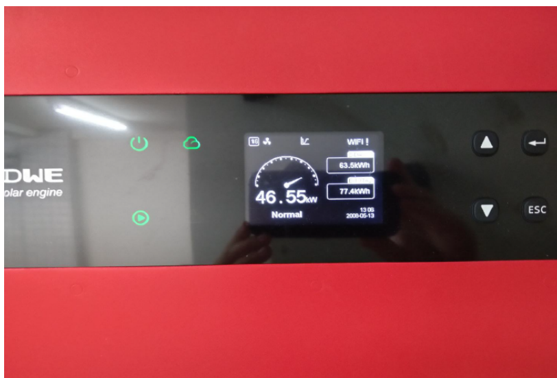
Foto 4: Inversores instalados no CEGEN - 50kWp
