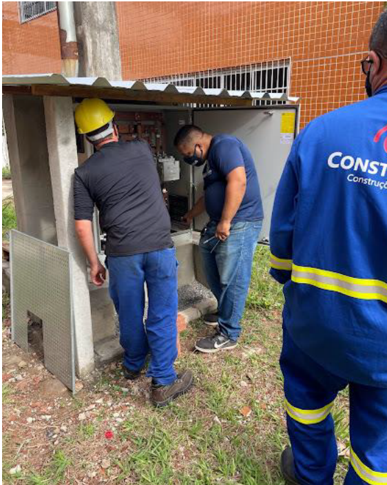
Foto 1: Comissionamento e start-up do gerador do DEPAQ.
