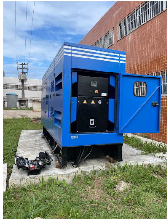
Foto 2: Comissionamento e start-up do gerador do DEPAQ.
