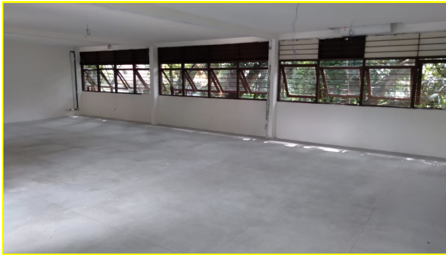
Foto 3: Aplicação de revestimento de piso em granilite nas salas que compõe o 1º e 2º Pavimentos (conforme projeto).
