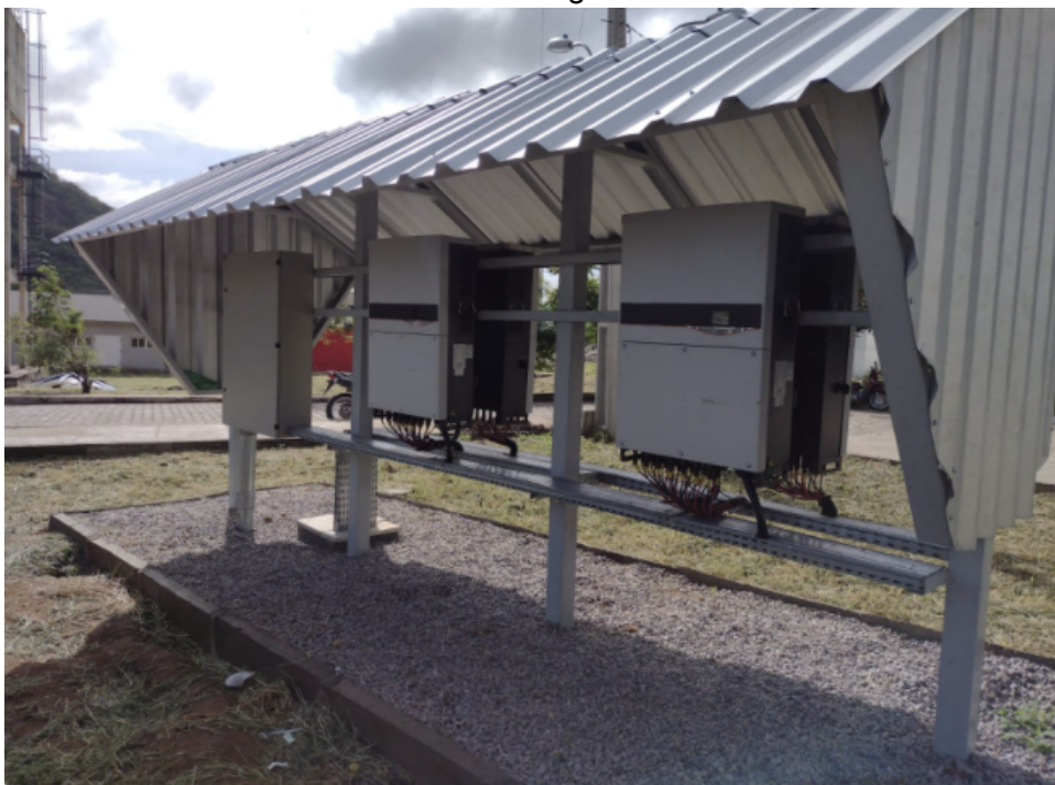
Foto 1: Abrigo de inversores
