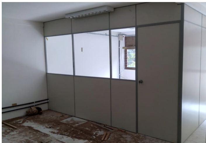
Foto 4: Instalação de painéis divisórios (tipo naval) com presença de vidro em salas do 1º Pavimento.
