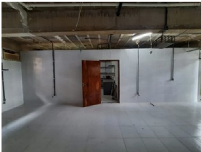
Foto 1: Revestimento, porta e infraestrutura elétrica.
