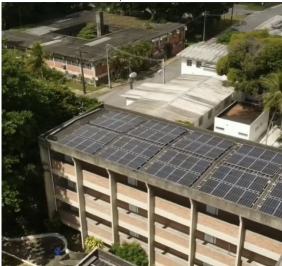
Foto 2: Vista aérea das placas instaladas no CEGOE
